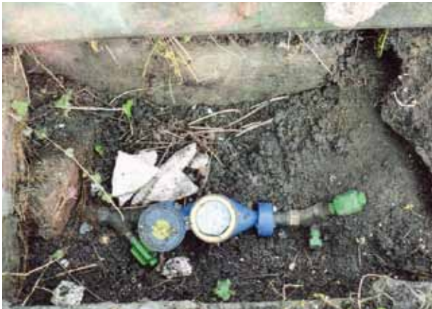
Hier ein unsachgemäßer Wasserzählerschacht
