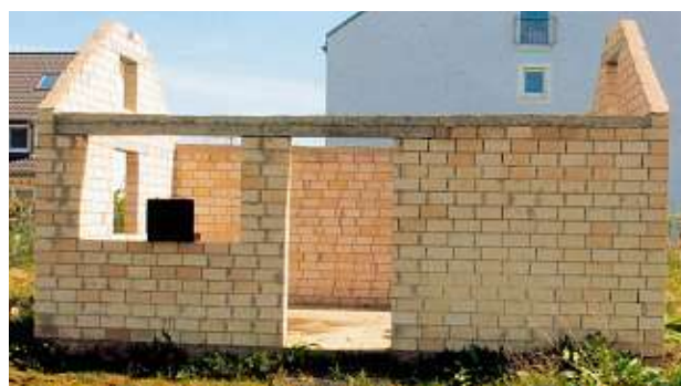
Auch diese freie Parzelle ist verwahrlost, das Gartenhaus befindet sich noch im Rohbau.
